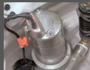
Pumpe mit Schwimmerschalter
